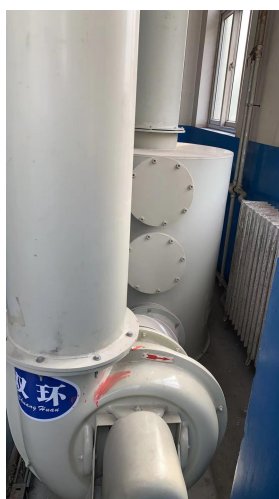
检验废气治理设施
